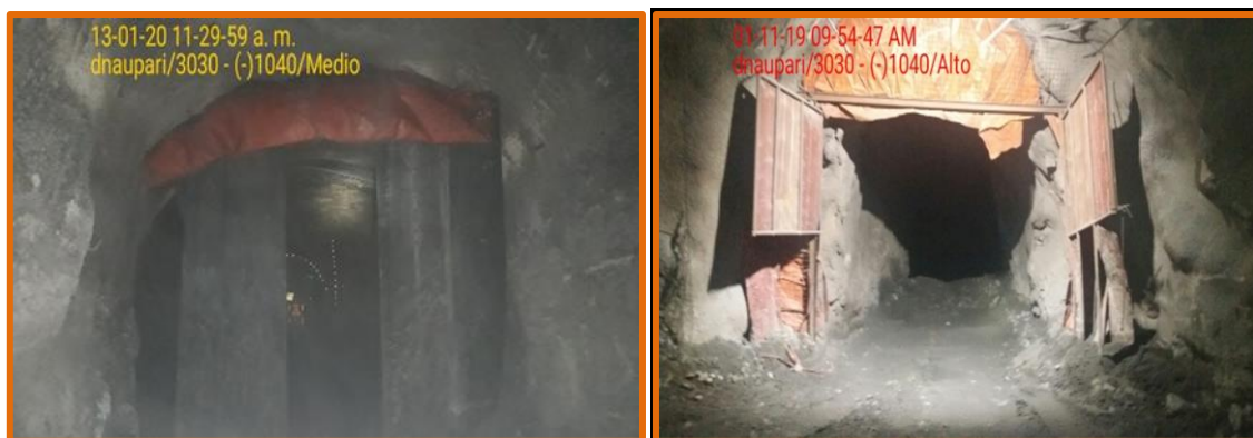
Ilustración 15: Cortina afectada por la operación (izquierda) y puerta afectada por los equipos (derecha).
