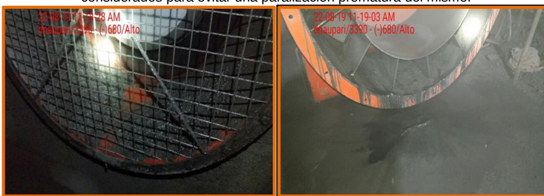
Ilustración 18: Presencia de humedad por compresión y material particulado adherido al ventilador.
