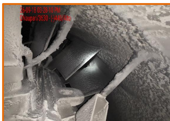
Ilustración 16: Extractor local afectado por la alta concentración de polvo en el aire.
